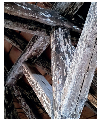
Trámy příliš důvěry nevzbuzují.
